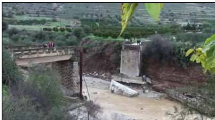
Εικόνα 3.6. Άποψη της γέφυρας στη θέση Λιβαδιταίικα της οδού Άκοβα – Χούνη στις 11-12-2007 (επάνω αριστερά), στις 04-12-2013 (κάτω αριστερά και στις 31-03-2016 (επάνω δεξιά).
