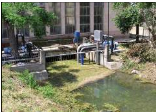
Εικόνα 2.60. Άποψη της ποσότητας νερού που εκφορτίζεται στην πηγή της Λέρνης στις 22-05-2008. Διακρίνονται οι εγκαταστάσεις για την άντληση νερού για την ύδρευση του Ναυπλίου και του Άργους.
