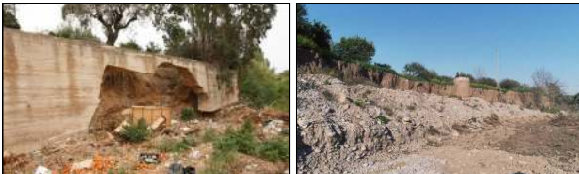
Εικόνα 2.34. Καταστροφές σε τοίχους αντιστήριξης και επένδυσης των πρανών, στη συμβολή του Ξοβριού με τεχνικά έργα της κύριας διώρυγας του αρδευτικού δικτύου της υποθαλάσσιας πηγής Κιβερίου, έπειτα από τα πλημμυρικά φαινόμενα του 2013 (αριστερά). Διεύρυνση της κοίτης (νεροφάγωμα), με χαρακτηριστική εμφάνιση πλινθόκτιστου πηγαδιού εντός αυτής (δεξιά).
